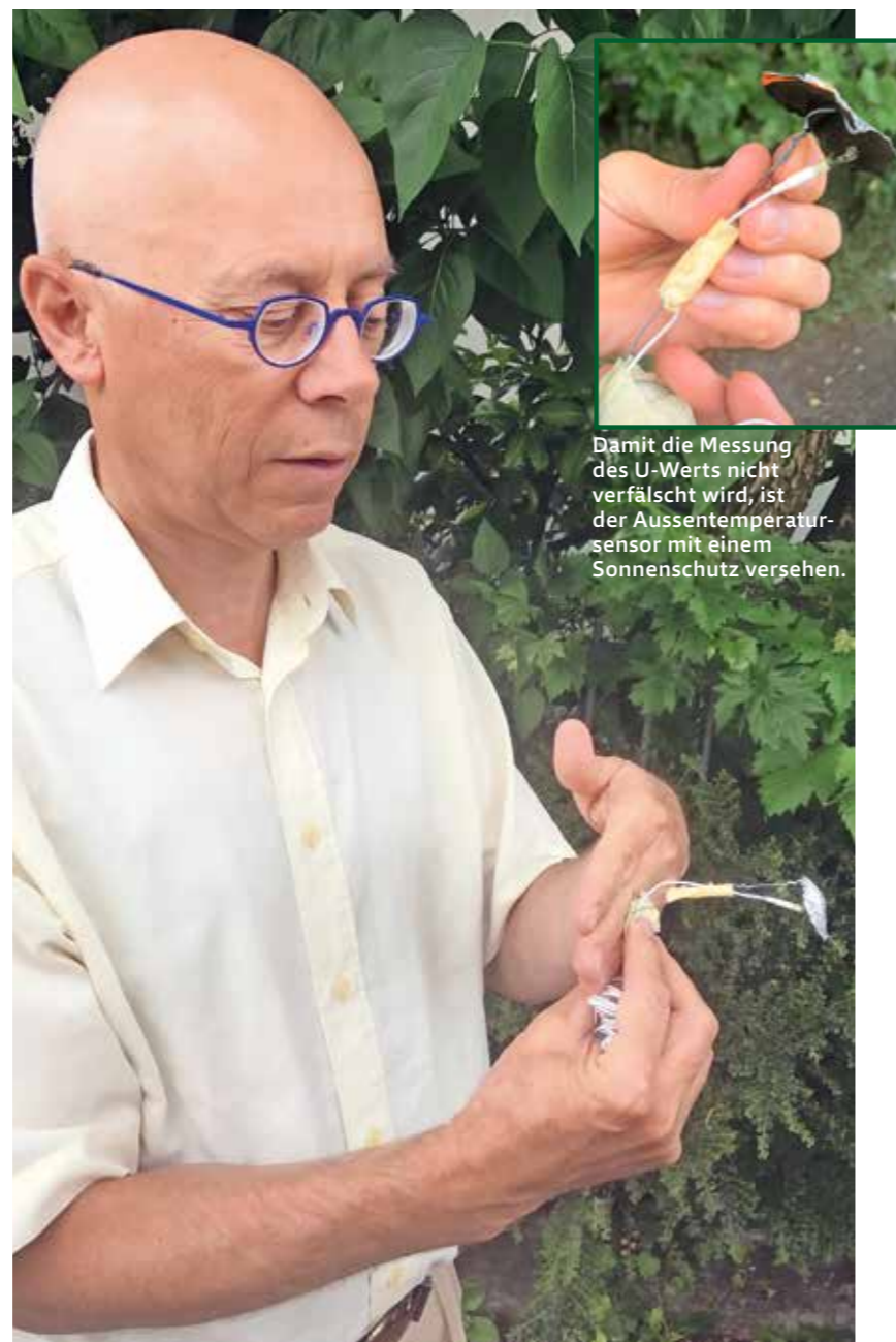
Werner Hässig, Inhaber der Hässig Sustech GmbH, zeigt, wie der Temperaturfühler des gSKIN-Messkits an der Aussenwand montiert wird, um den U-Wert zu messen.
