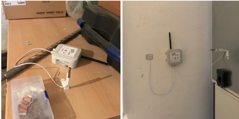
Abbildung 3-2: Messknoten vom Typ 3 zur Messung der relativen Luftfeuchte (links oben/unten) und Messknoten vom Typ 2 zur Messung der Wandtemperatur (rechts oben/unten)
