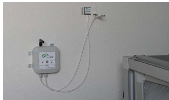
Abb. 4: gOMS-Sensoren zur Messung von Wärmefluss, Oberflächen- und Raumlufttemperatur an der Innenwand von Büro B5
